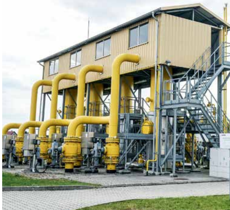
Εγκατάσταση εισαγωγής ρωσικού φυσικού αερίου έξω από τη Βαρσοβία. Η απόφαση για αποκοπή της Πολωνίας και της Βουλγαρίας υπογραμμίζει την αυξανόμενη επισφάλεια της ενεργειακής σχέσης μεταξύ Ρωσίας και Ευρώπης.
